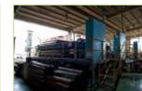
化學污泥板框壓濾機
