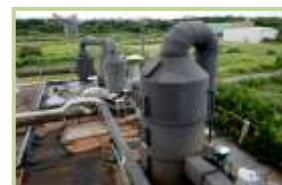
生物廢水廢氣塔
